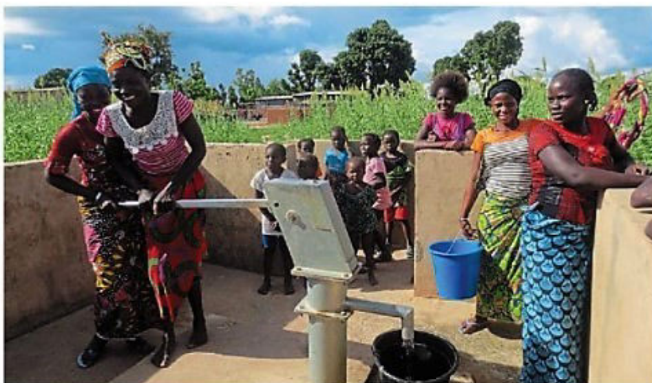
Des pompes manuelles sont installées par Forage Mali au cœur des villages.
